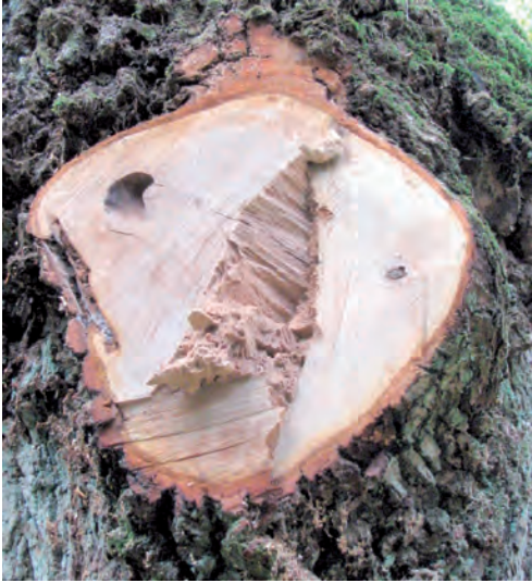
Fot. 143. Nieprawidłowo wykonane cięcia gałęzi i konarów sprzyja infekcji grzybów ranowych w drzewach
